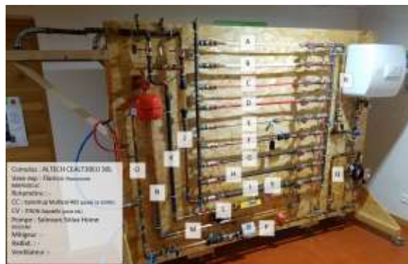
Banc d'essai hydraulique d'Enertech pour la vérification et l'étalonnage des compteurs de chaleur.
