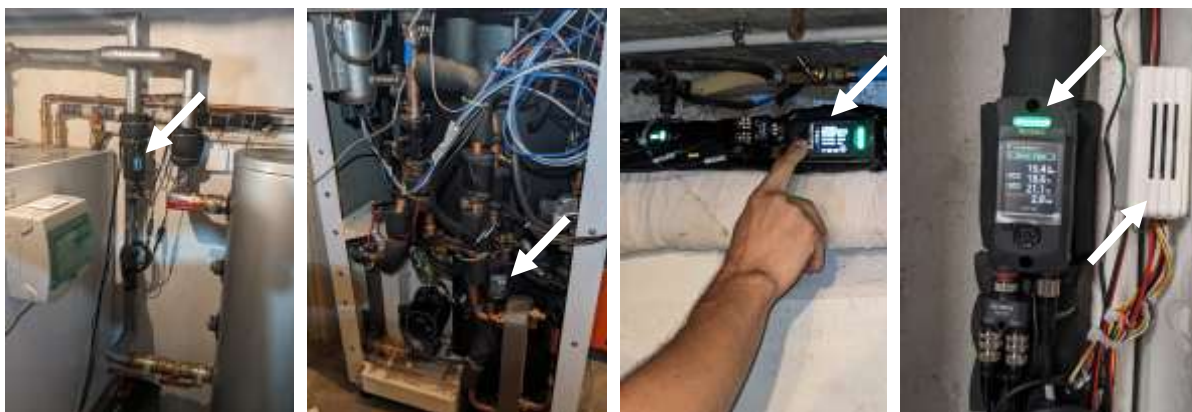
Figure 8 : Exemples de poses de compteurs de chaleur
