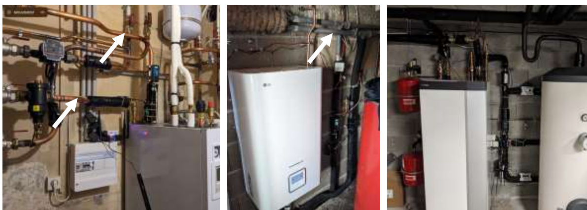
Figure 35 : Illustration de différents niveaux de calorifugeage des installation (à gauche non calorifugé, à droite bien calorifugé)
